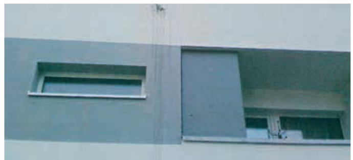
Fassadenbeschädigung Überlinger Straße 9
