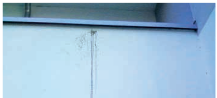
Fassadenbeschädigung Überlinger Straße 15
