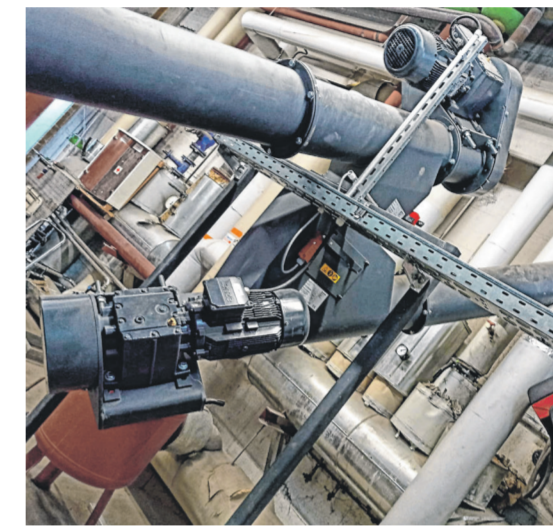
Heiztechnik im Heizhaus Überlinger Straße 11 in Singen.
